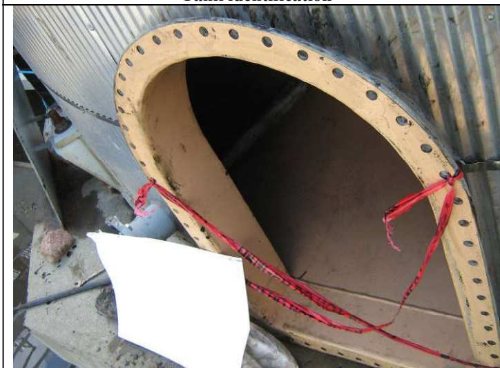
Manway/ Access Door
