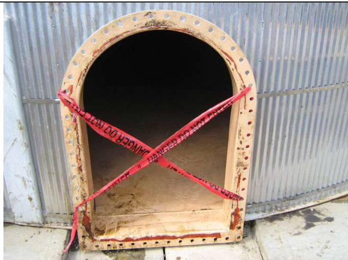
Manway/ Access Door
