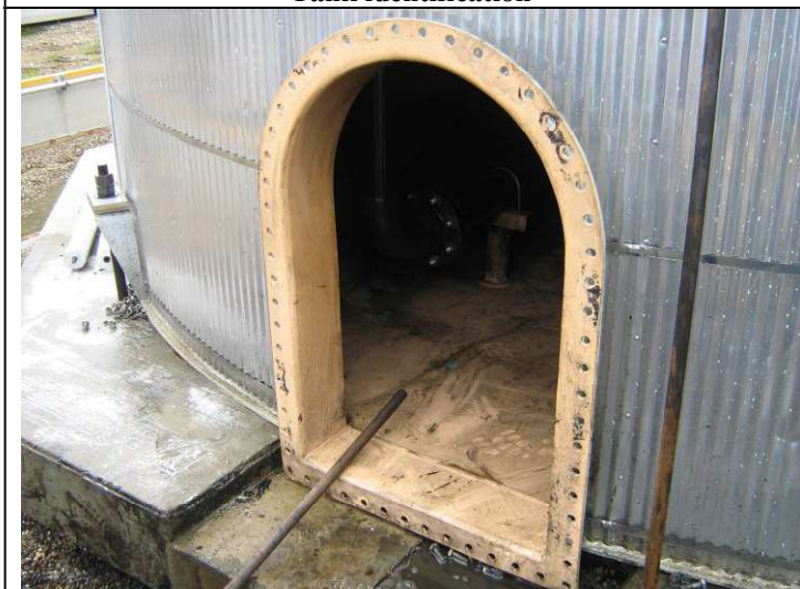
Manway Access door
