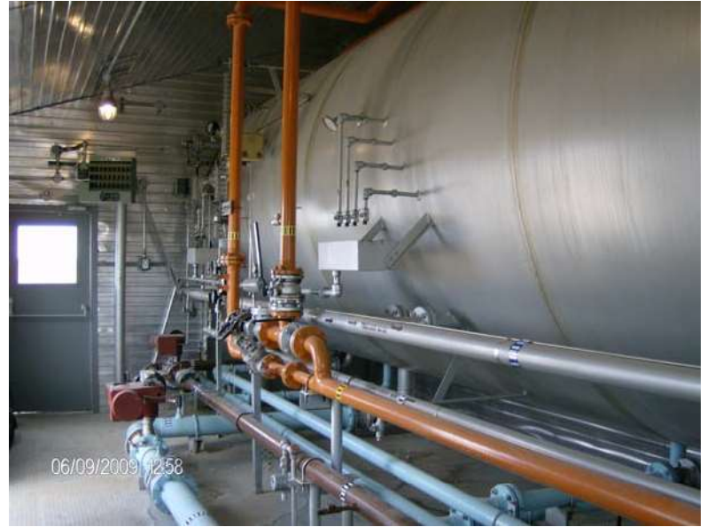
Grand Forks-FWKO_Inside Bldg.
