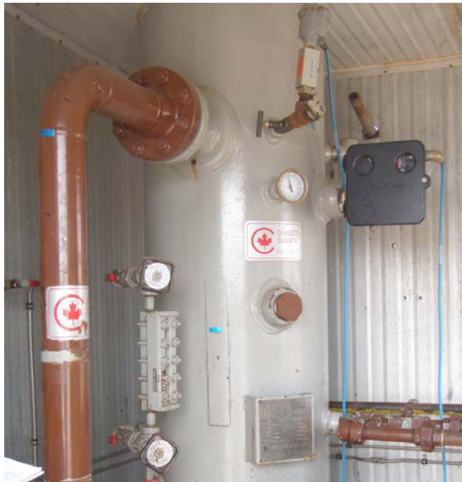
02-A0432472 Overview Inside
